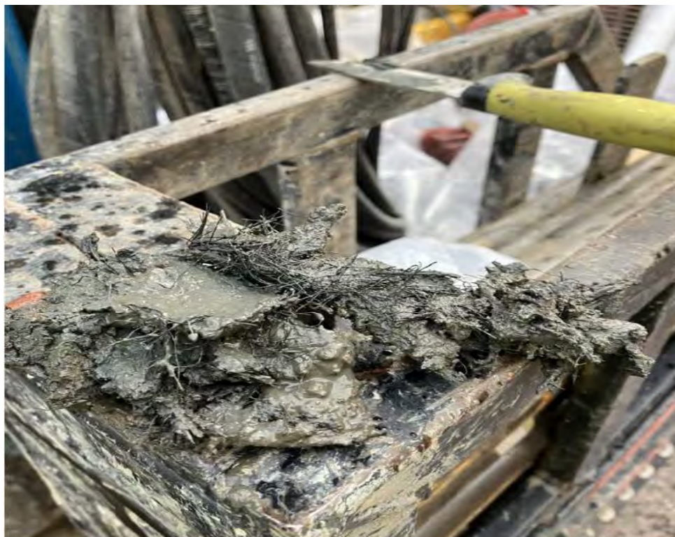
Figur 8. I provpunkt 22M25J påträffas fibrer av troligtvis säckväv. I samband med förekomsten förekommer petroleumlukt.
